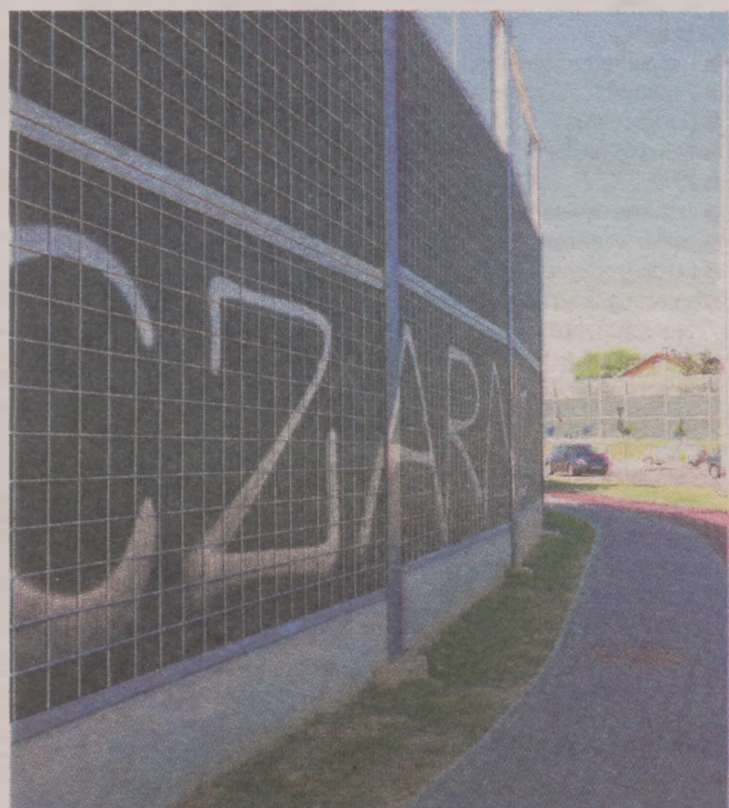
► Tak wyglądają pomalowane przez wandalów ekrany dźwiękochłonne na słupskim ringu. Zarząd Infrastruktury Miejskiej zapowiada, że będzie chciał je wyczyścić
