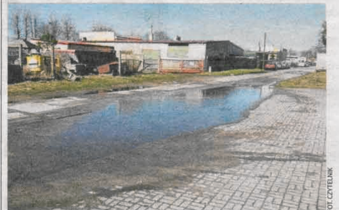
► Nawierzchnia ul. Borchardta, zniszczona przez ciężki sprzęt budowlany, ma być niebawem naprawiona
