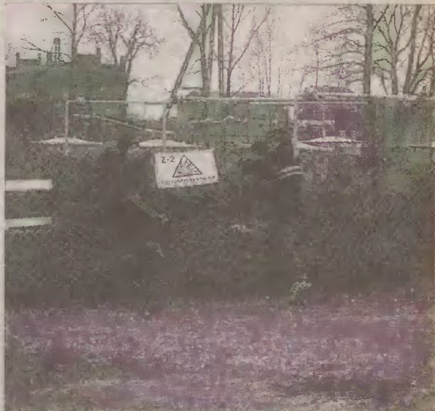
Pomiędzy blokami na osiedlu zamontowano zbiorniki gazu.
