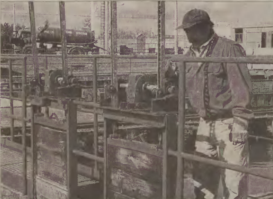
Bogdan Kiciński, operator oczyszczalni ścieków, w trakcie pełnienia swoich obowiązków.
