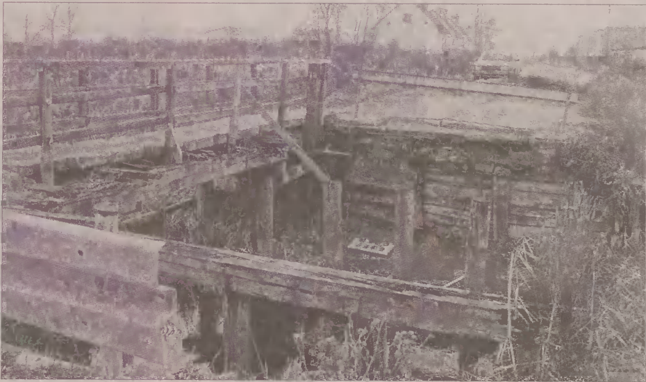
Koszt uruchomienia tego przejścia będzie kosztować 100 tys. złotych. Dzierżawca pól w Węzowcu, który zniszczył most, nie zamierza partycypować w kosztach naprawy.
