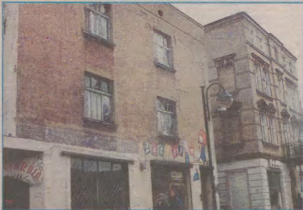
Na tczewskiej starówce wiele jest jeszcze budynków ze zniszczoną elewacją.
