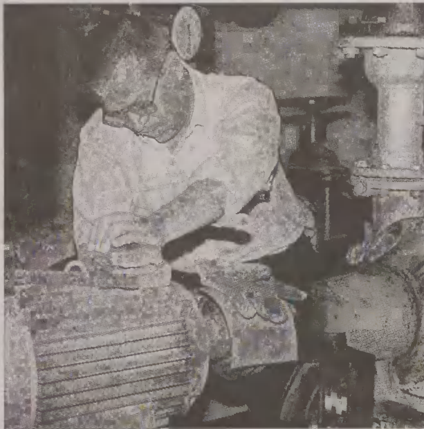
Marek Przepiera konserwuje pompy cyrkulacyjne wody basenowej.
