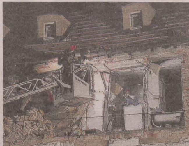
► Skala zniszczeń jest duża. Uszkodzona jest konstrukcja budynku
