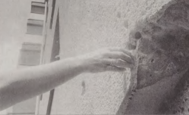
Niedawno przewiercono ściany domu. Okazało się, że budynek jest źle ocieplony. Zimą daje się to szczególnie we znaki...
