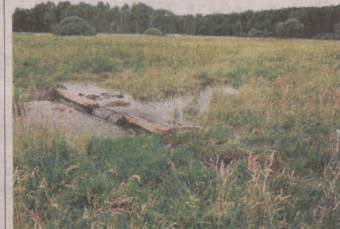
Jedna z 26 zastawek na rowie melioracyjnym - wybudowano je, żeby spowolnić odpływ wody z torfowiska
