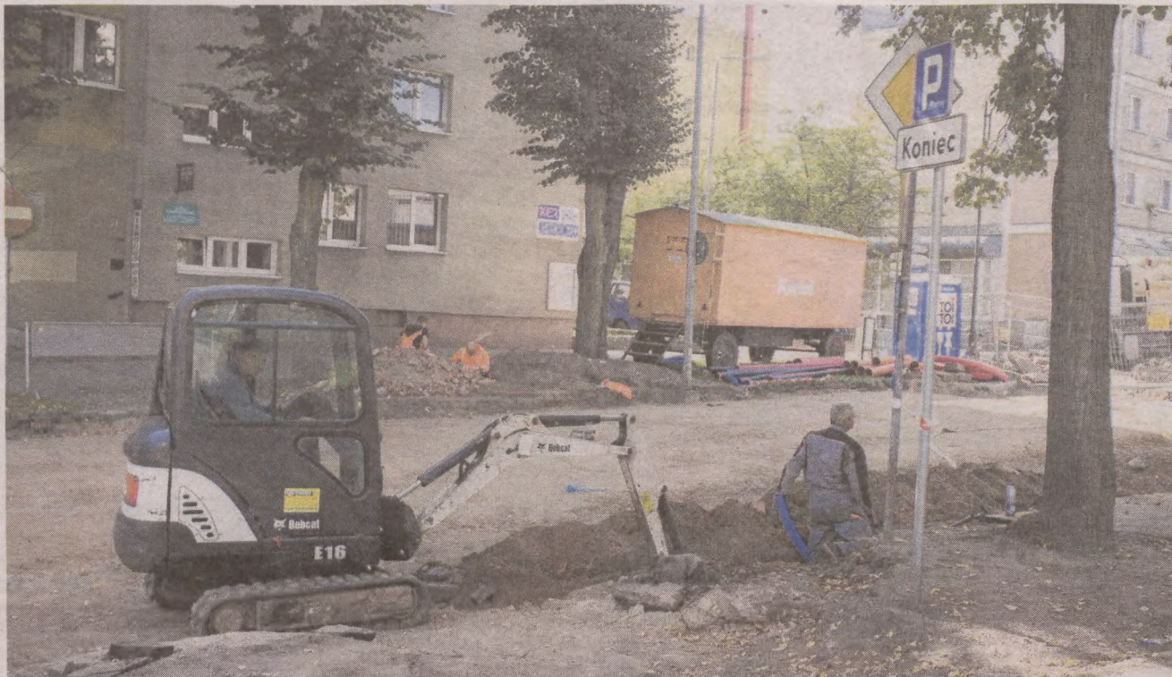
Gdy drogowcy rozkopali pas drogowy na skrzyżowaniu Starego Rynku i ulicy Kowalskiej w Słupsku, odkryli instalacje, których się tam nie spodziewali
