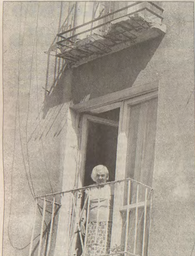
Janina Bielawska miała szczęście. Gdy spadła część balkonu jej sąsiadów mieszkających piętro wyżej, oglądała telewizję.
