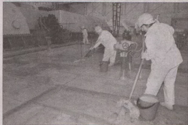
Sprzątaczkę przy turbinach wycierają szmatami brud i pył radioaktywny.
