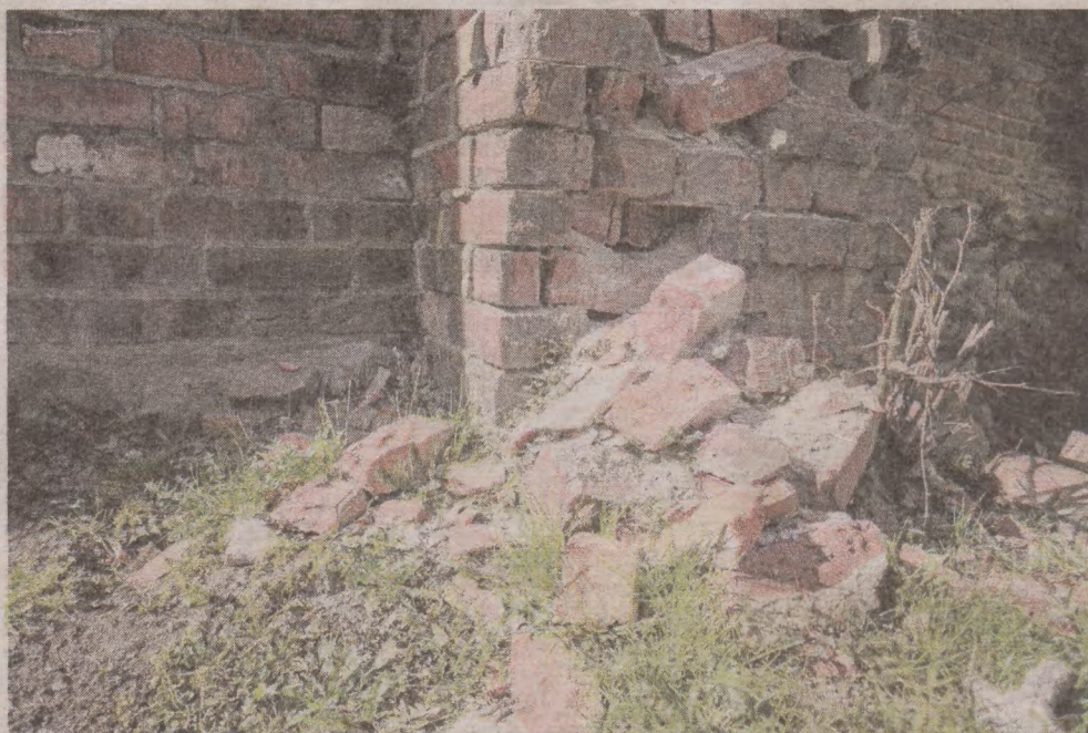
Jak widać, woda i wiatr spowodowały, że niektóre fragmenty murów obronnych są w takim stanie
