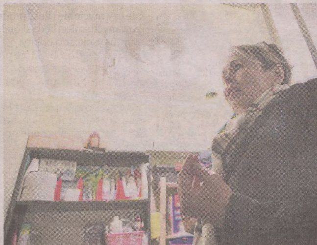
Dach przecieka i nadaje się cały do wymiany. Stanowi zagrożenie, bo przecieka także tam, gdzie jest elektryka
