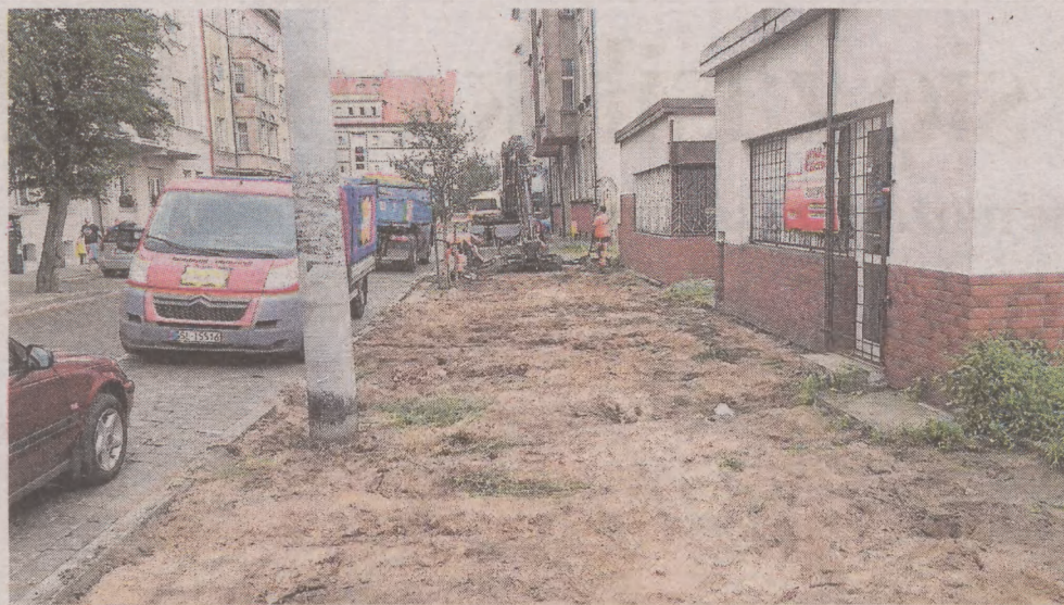
Już w poniedziałek pracownicy firmy Krężel zrywali stare chodniki przy ul. Władysława Reymonta. Mieszkańcy mają nadzieję, że nowe chodniki zmienią obraz ulicy
