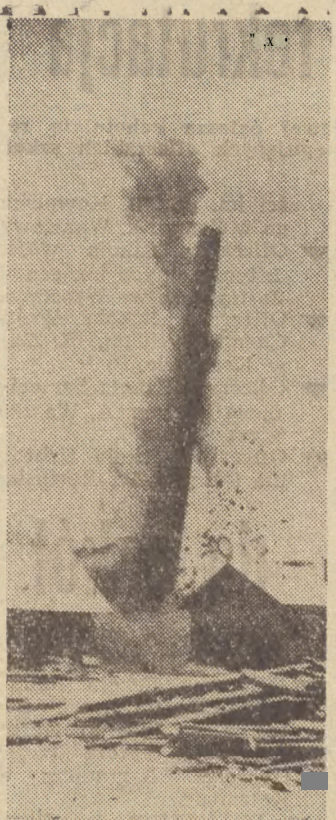
W cementowni w Radotinie niedaleko Pragi — runął kilka dni temu 82-metrowy komin. Po rozebraniu szczątków kominu można będzie uzyskać aż 300 tysięcy cegieł.
