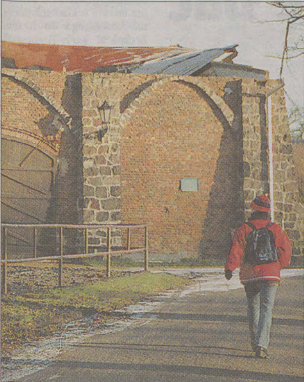
Wiatr zerwał dach stajni w Kolibkach.
