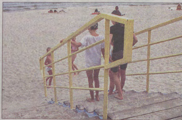
Z powodu braku desek w schodach nietrudno skaleczyć nogi.
