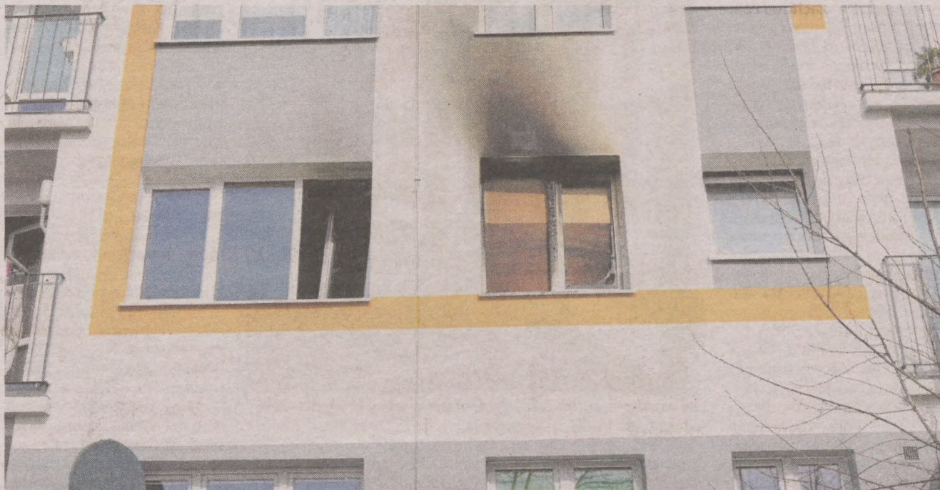
W czwartek po godzinie 16 w bloku przy ul. Pochyłej w Bytowie wybuchł pożar. Z bloku ewakuowano 12 osób, w tym 5 dzieci. Zgłoszenie było bardzo poważne. Dzieci miały być w mieszkaniu, gdzie wybuchł pożar
