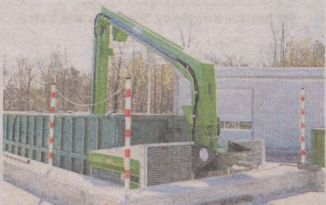
Ustecki PSZOK jest wyposażony m.in. w maszyny umożliwiające szybkie zgniatanie wyselekcjonowanych odpadów
