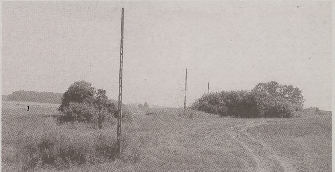
Fragment odcinka linii po kradzieży przewodów w miejscowości Rogajny, gmina Pasłęk. Jak widać złodzieje pozostawili tylko słupy.
