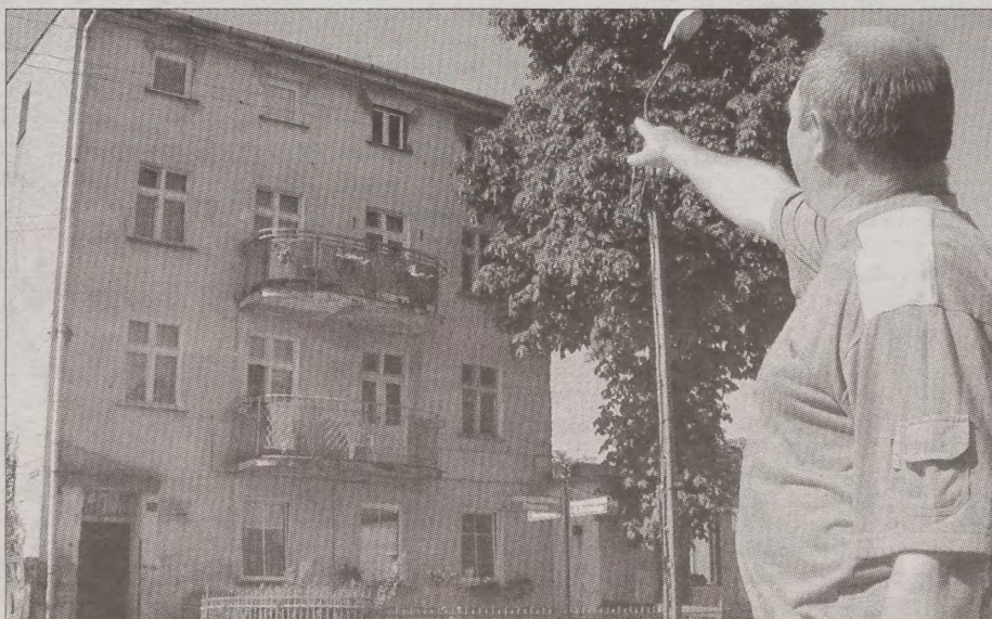
Ignacy Staniszewski pokazuje pęknięcia na murach spowodowane drganiami.
