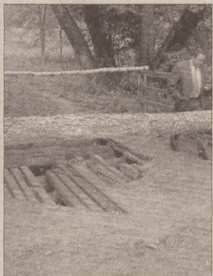
Most w Lasce zamknięto, gdyż groził zawaleniem.
