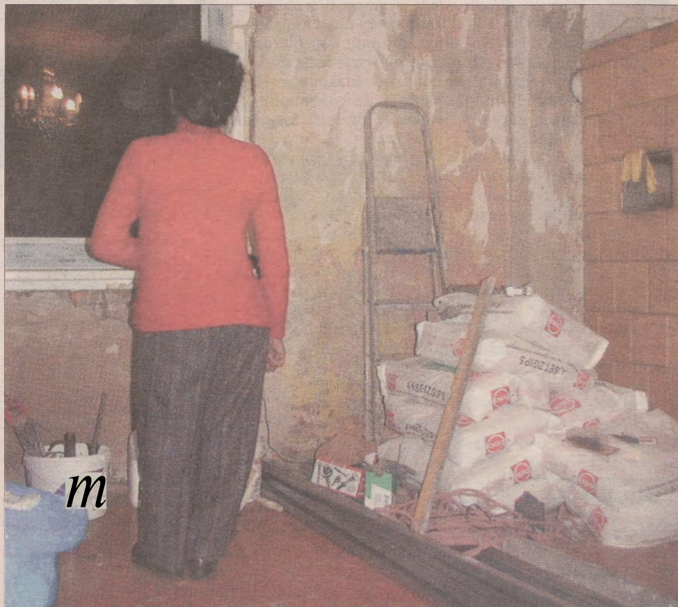
W mieszkaniu naszej Czytelniczki zalegają materiały pozostawione przez firmę budowlaną.
