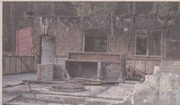
Spalony bar piwny, w którym odbywały się dyskoteki, od ponad roku grozi zawaleniem się.
