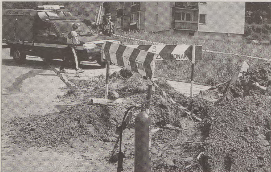
Eksplzji gazu zapobiegł silny wiatr.
