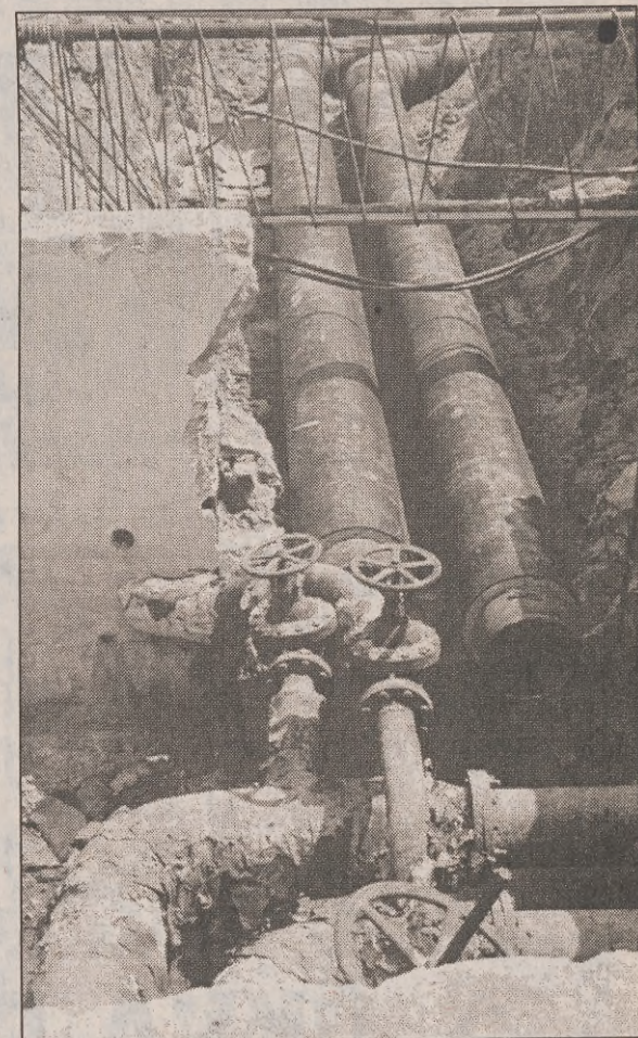
Olbrzymie rezerwy tkwią u nas jeszcze w sposobach przesyłania energii elektrycznej i ciepłej. Każda modernizacja sieci przesyłowej to tony zaoszczędzonego węgla.
