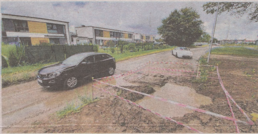
Na ul. Legionów Polskich zabezpieczono tylko największe dziury w ziemi, które po opadach zamieniły się w głębokie kałuże
