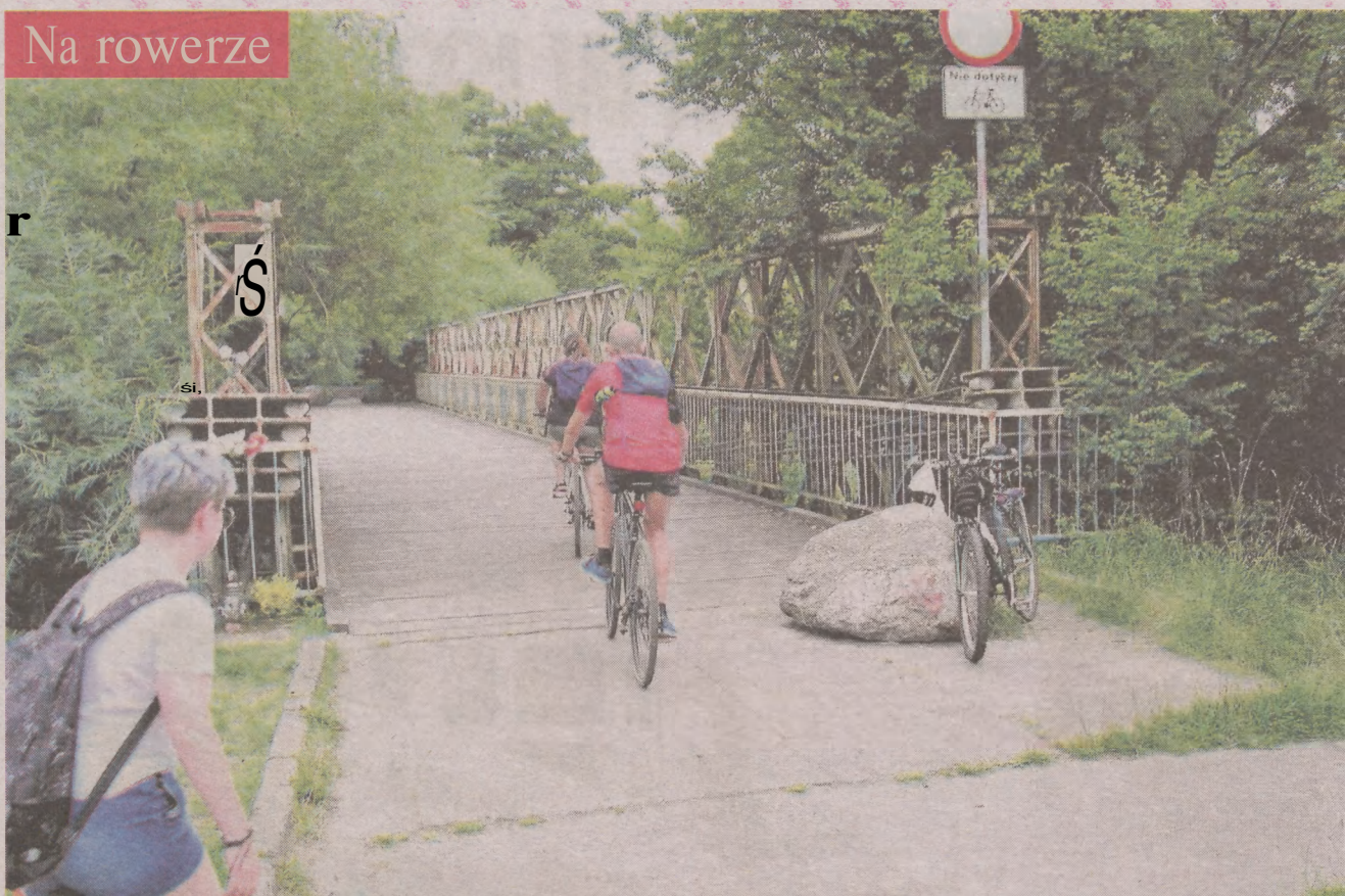
Lubiany przez turystów, wycieczkowiczów i rowerzystów Most Czołgów wymaga odrdzewienia konstrukcji oraz wytłumienia
