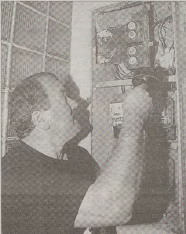
Ptaki zagrażają instalacji elektrycznej w bloku.
