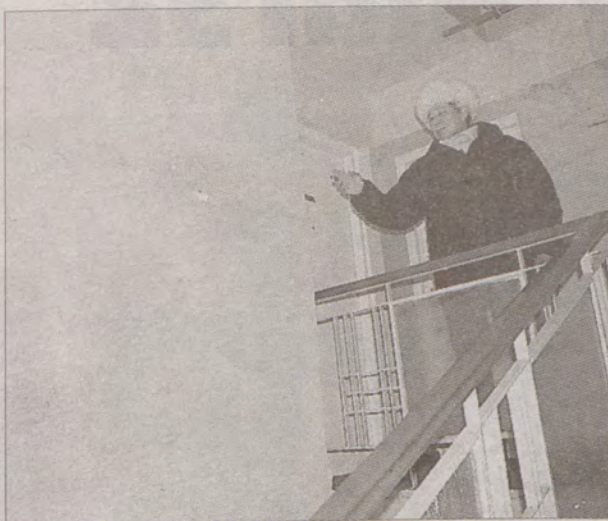
Aleksander Bogdanowicz pokazuje pęknięcia na ścianie.
