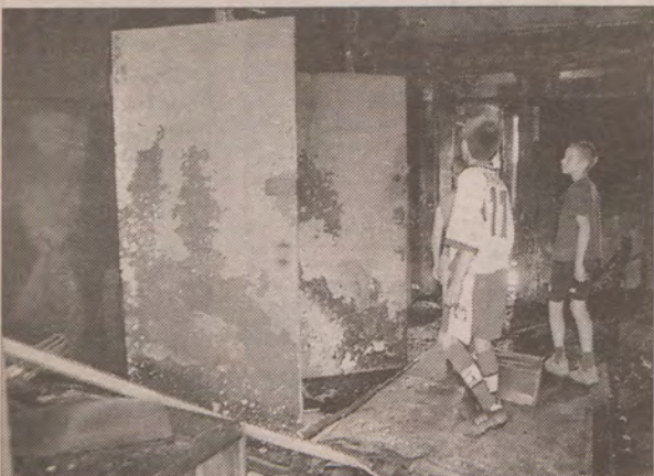
Podczas pożarów na szczęście obeszło się bez ofiar. Budynki trzeba jak najszybciej rozebrać.
