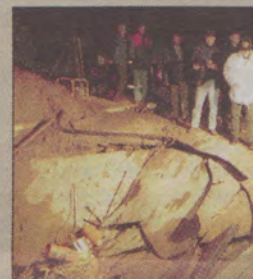
W październiku 1999 r. 32-letni mężczyzna zginął podczas prac remontowych w Gdyni.
