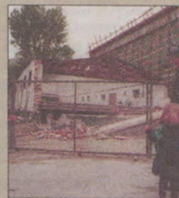
W maju 1998 r. 65-letni mieszkaniec Gdańska zginął na placu budowy kościoła pw. NMP przy ul. Marynarki Polskiej.
