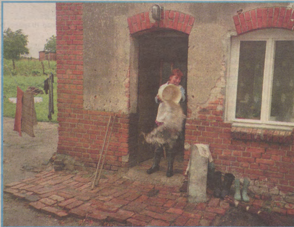
Grażyna Chmielecka wylewa wodę deszczową z piwnicy.
