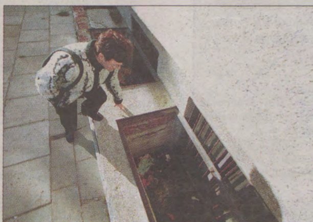
Lokatorzy domu przy ul. Gdańskiej domagają się wyremontowania budynku. Na zdjęciu Grażyna Mirosław.
