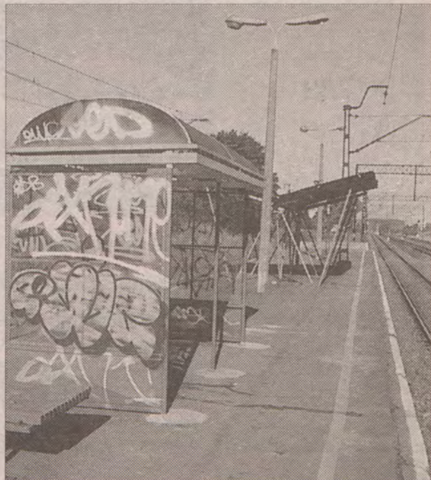
Przystankowi SKM Rumia Janowo, z pewnością potrzebny jest gruntowny remont.
