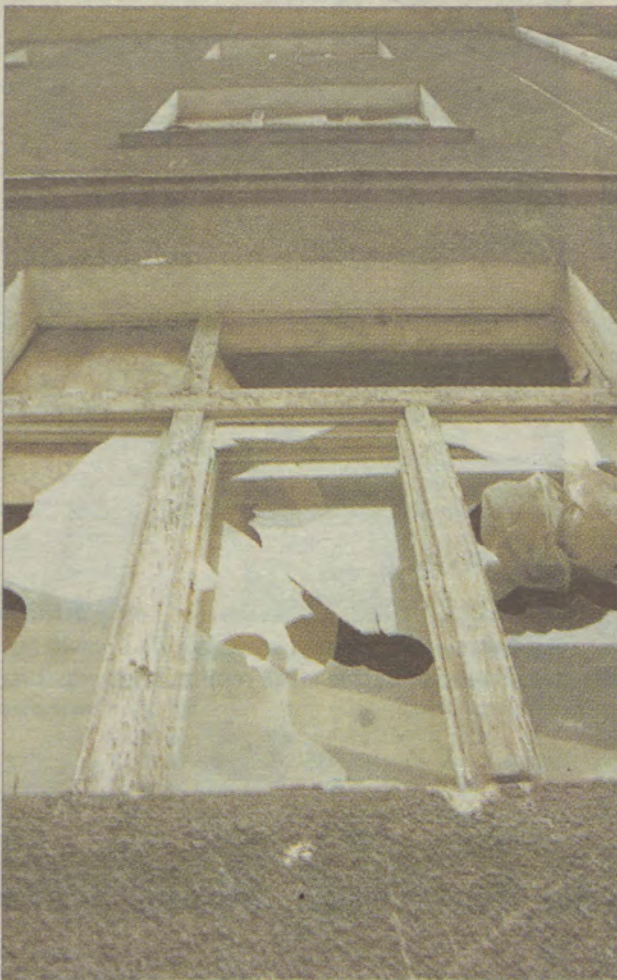
Ulica Drewniana. Elewacje po raz ostatni były remontowane kilkadziesiąt lat temu.
