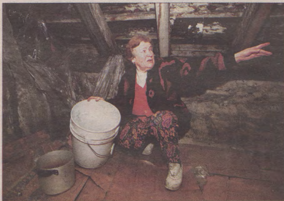
Dziurawy dach jest złą sprawą mieszkańców domu przy ulicy Glinki 2 we Wrzeszczu. Na zdjęciu Janina Czepukojć.
