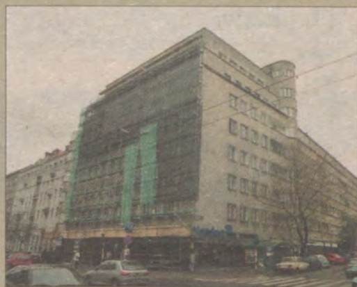
Odfamki płyt elewacyjnych zaczęły już spadać na ulicę. Remont był konieczny.
