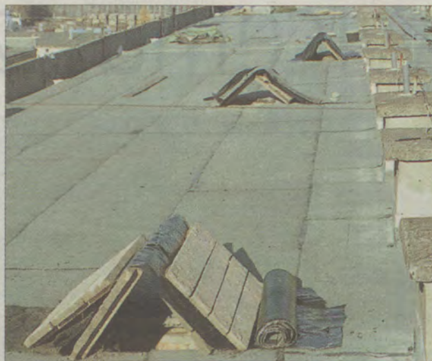
Na dachu budynku przy ul. Handlowej straszą dziury.
