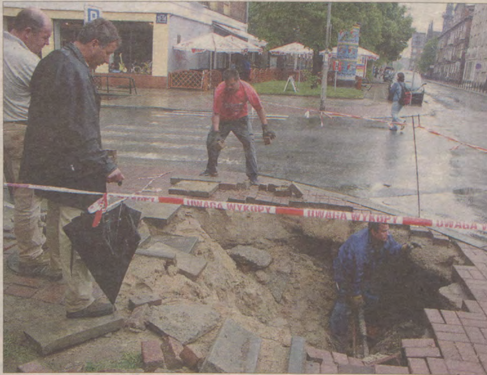
W Gdańsku przy ulicy Kołwalskiej deszcz podmył chodnik.
