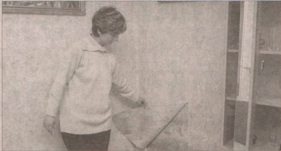
Od wielu lat w budynku panuje wilgoć. Krystyna Dąbrowska pokazuje odklejoną od ściany tapetę.
