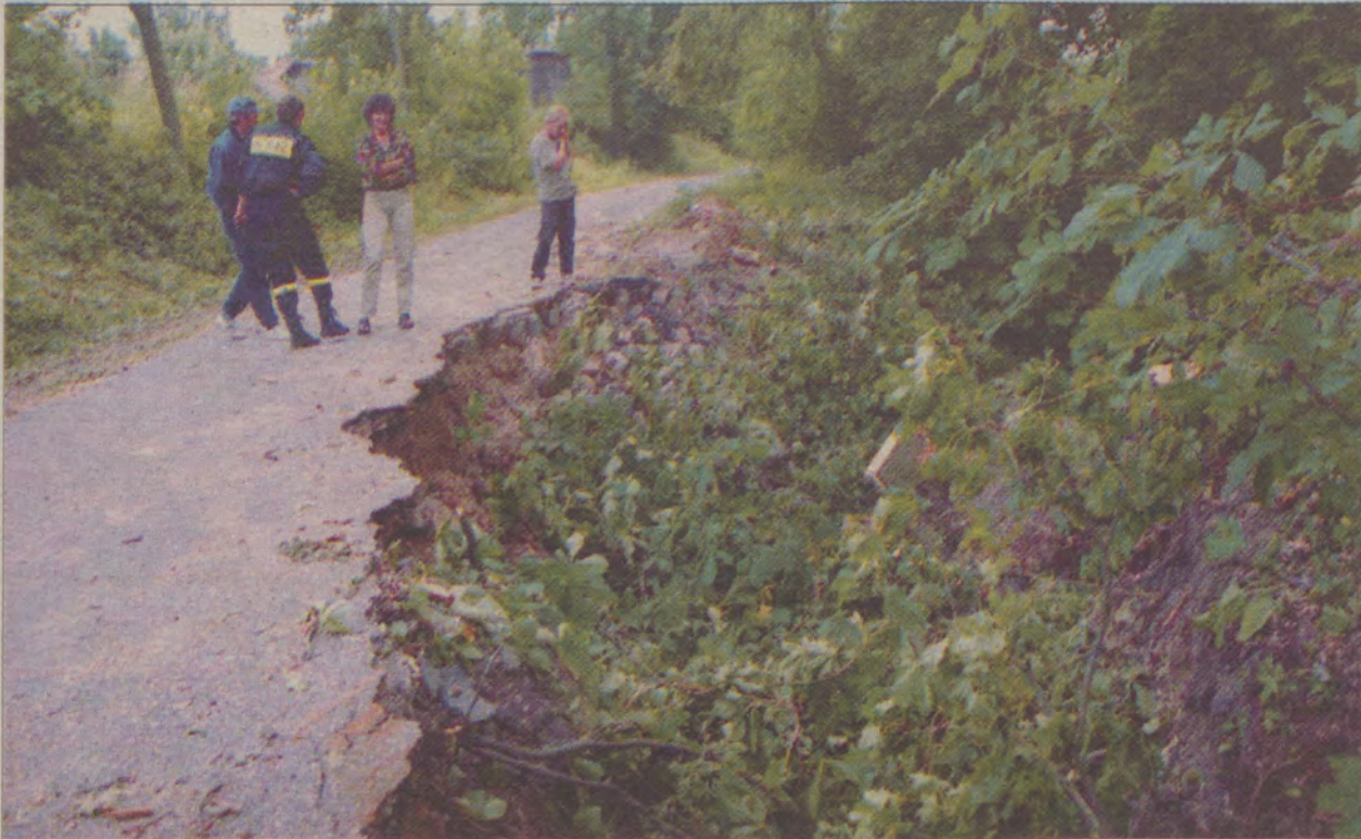
W Opaleniu Widlicach strugi wody spowodowały obsunięcie się drogi.
