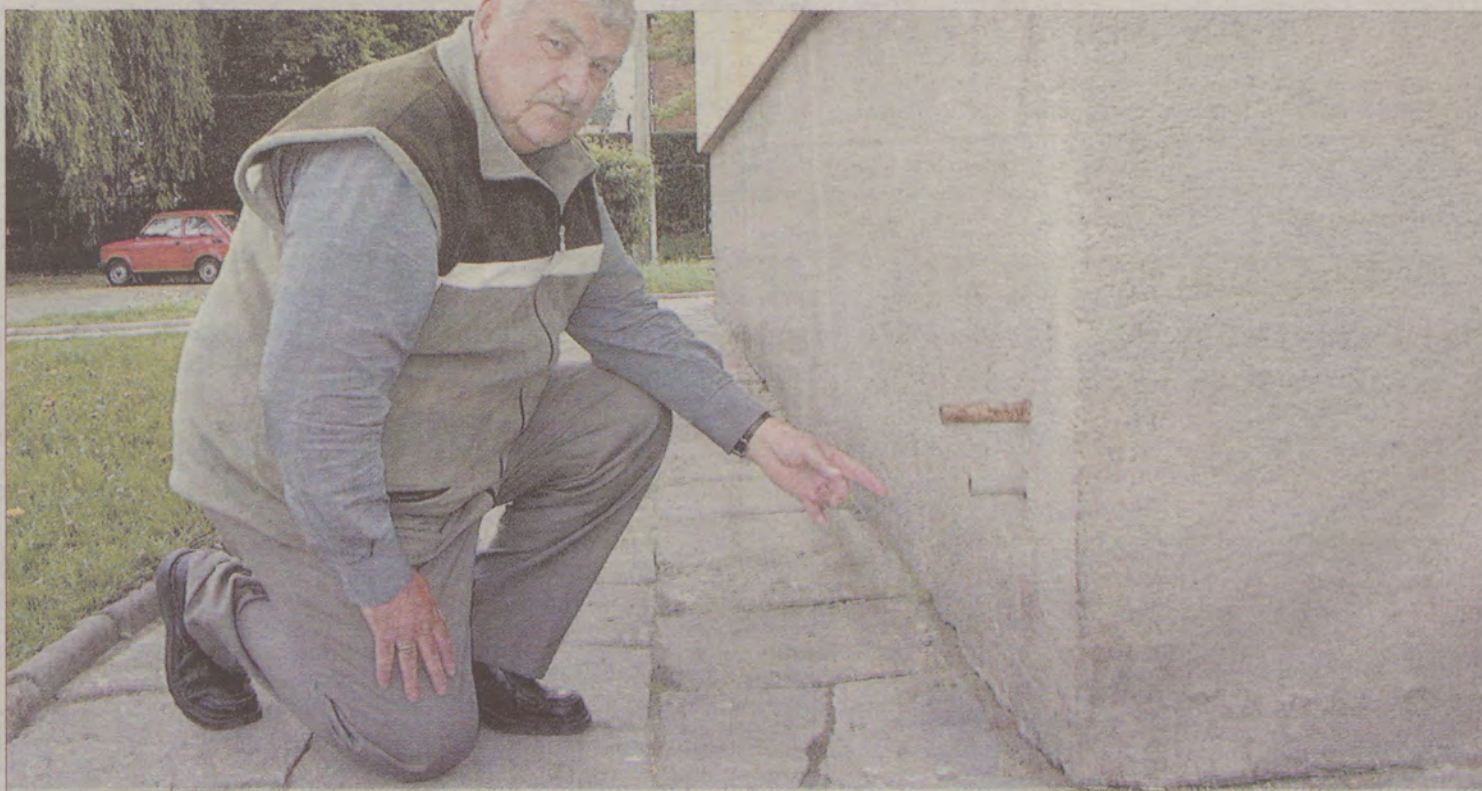
Grzegorz Kuhl, mieszkaniec bloku przy pl. Narutowicza 13, często obserwuje stan murów budynku. Kilkumilimetrowe szczeliny, których tak boją się lokatorzy, są widoczne gołym okiem.
