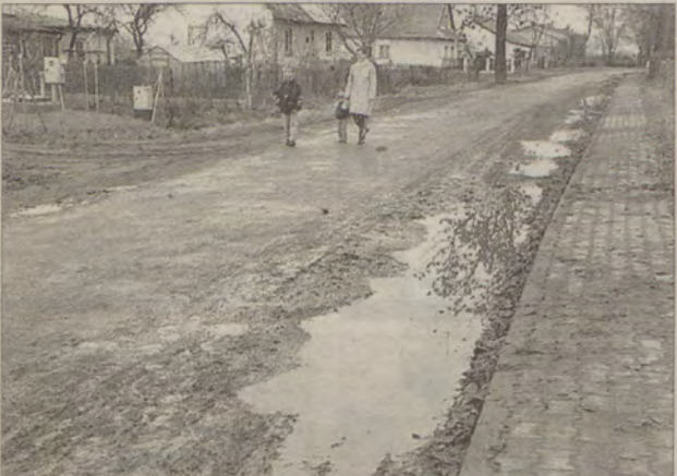
Ulica Główna w Miłoradzu. Gdy popada, trudno jest przejść tędy suchą nogą.
