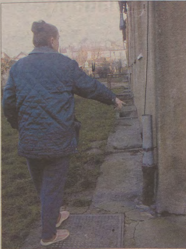
Urwana rynna to jedno z wielu uszkodzeń budynku przy Zakolu 9.
