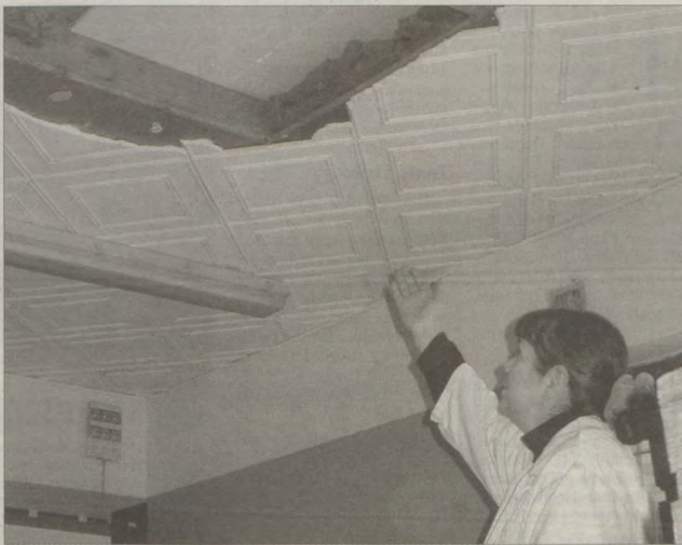
W nocy z piątku na sobotę złodzieje odwiedzili sklep po raz siódmy – tym razem weszli przez dach - pokazuje Bożena Bukowska.
