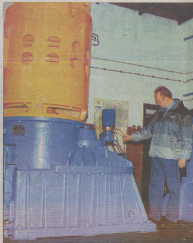
Zabytkowa stacja pomp w miejscowości Oślonka.
