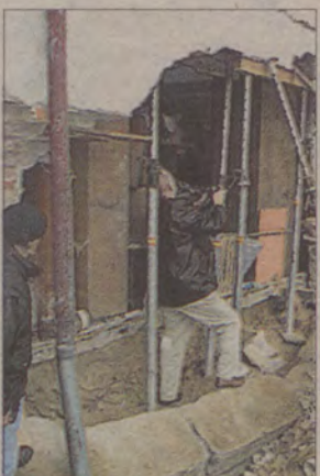
Lokatorów ewakuowano, pozostała część budynku zabezpieczono.
